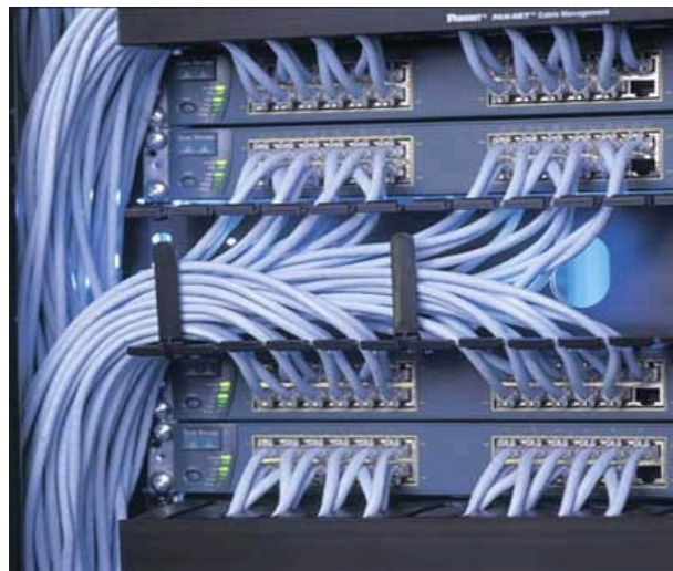
Figura 3.5 - Distribuição de cabos ethernet em um painel
